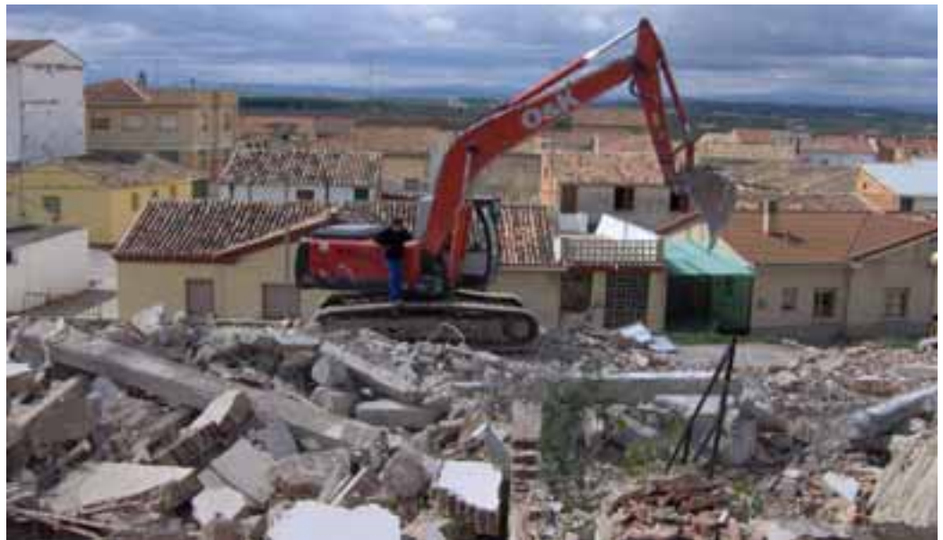
Labores de derrumbe que fueron acometidas tras la aparición de las grietas. / ENFOQUE.
