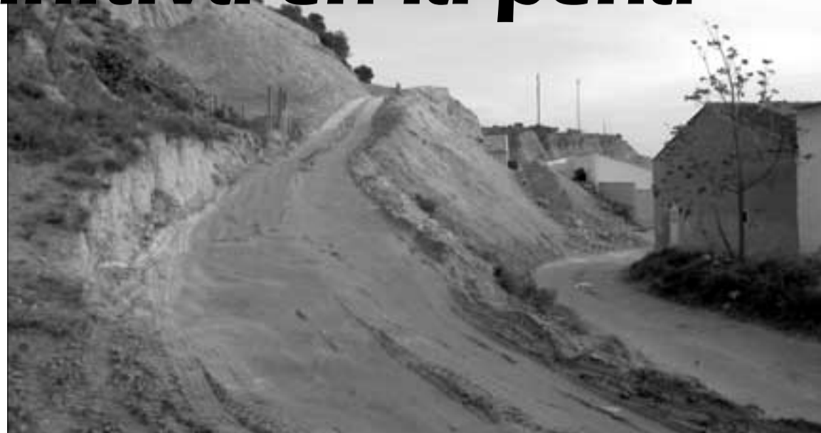
Trasera de la calle Príncipe de Viana donde se llevan a cabo las obras de estabilización de la peña.
