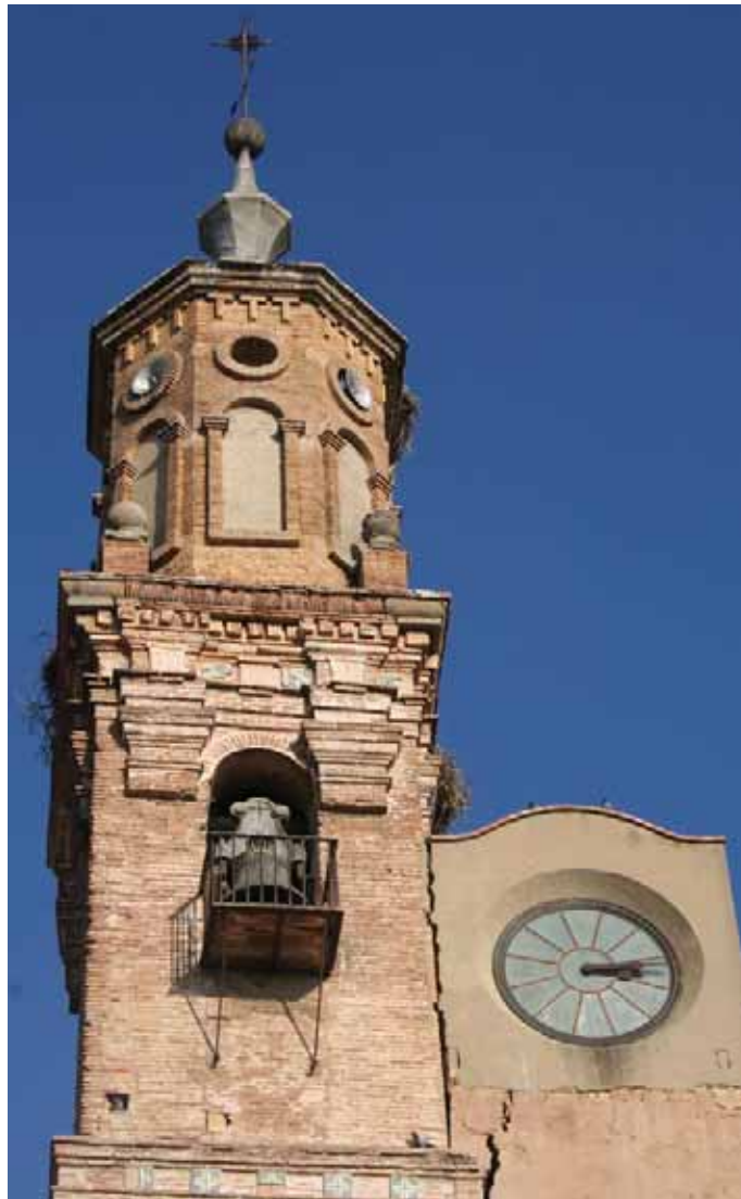
La torre se encuentra muy deteriorada y presenta numerosas grietas. / ENFOQUE.
