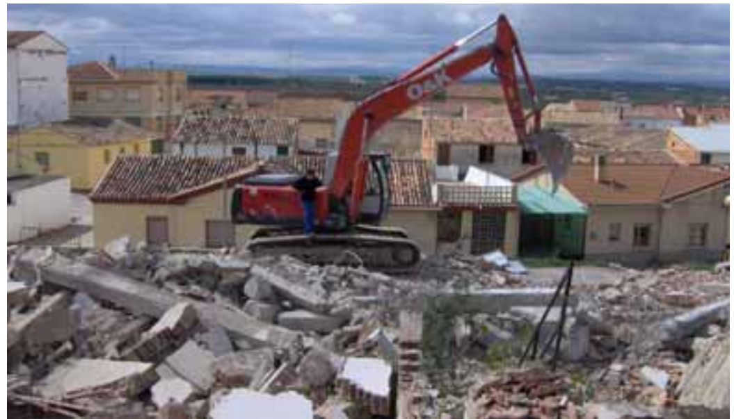
Labores de derrumbe que fueron acometidas tras la aparición de las grietas. / ENFOQUE.
