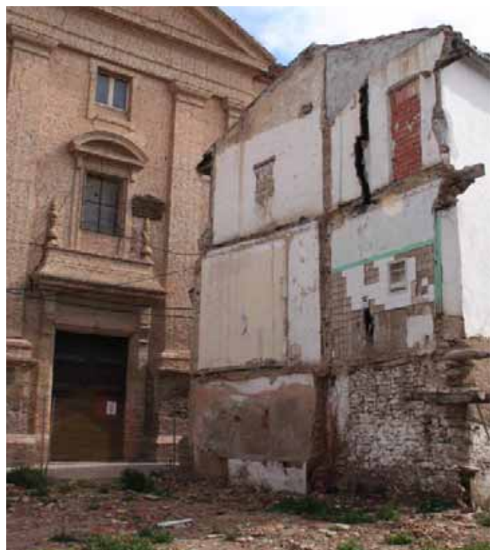
Vista de la pared desnuda del edificio contiguo al que fue derribado. / ENFOQUE.
